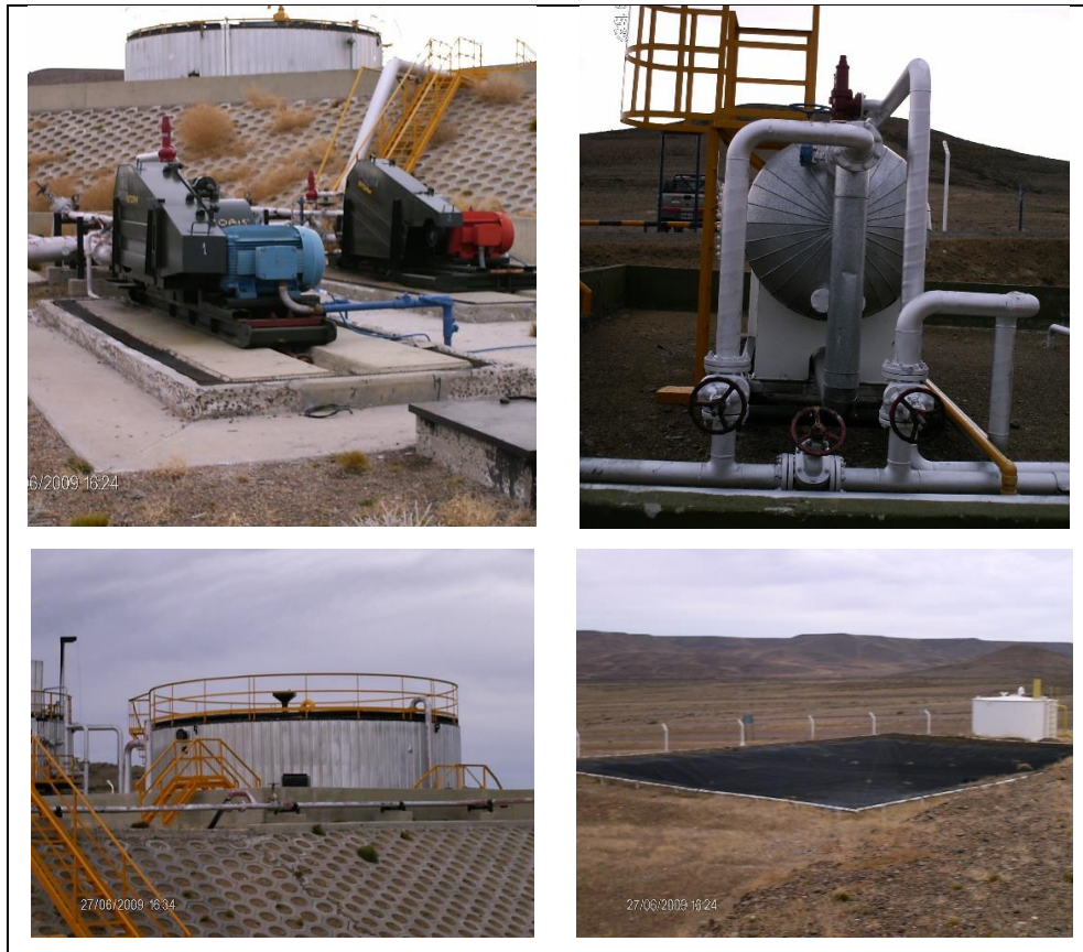
Imagen: parque de bombas, separador horizontal, tanque stock y pileta de emergencias.
