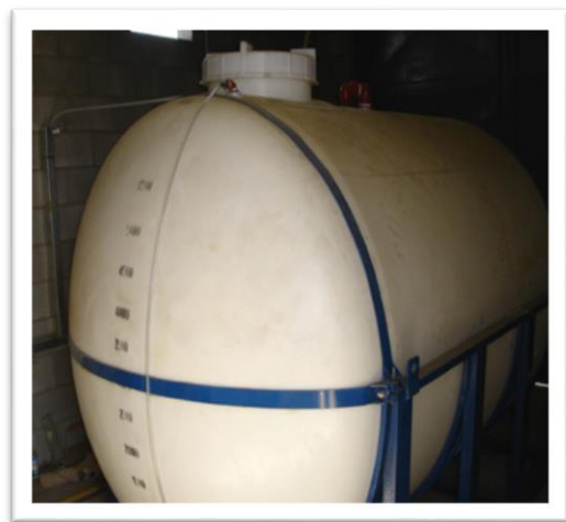
Figura 7e. Tanque de desinfección. Fuente: Fotografía con autorización de SPE, 2004.
