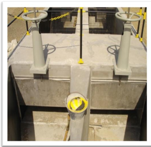
Figura 7a. Rejas de retención de sólidos.
