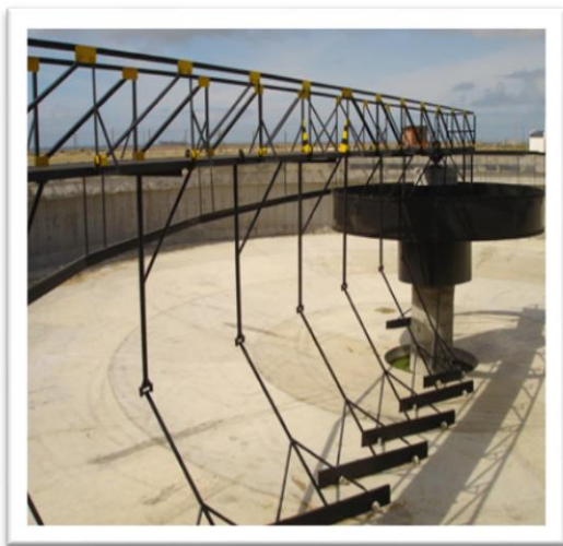
Figura 7c. Sedimentador secundario con barredores. Fuente: Fotografía con autorización de SPE, 2004.
