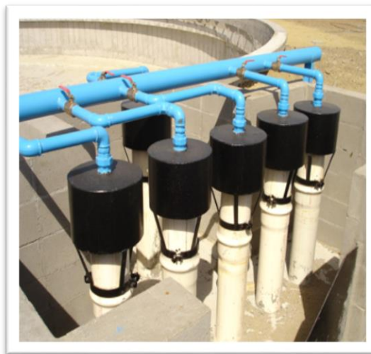
Figura 7d. Bombas neumáticas de recirculo de barros. Fuente: Fotografía con autorización de SPE, 2004.
