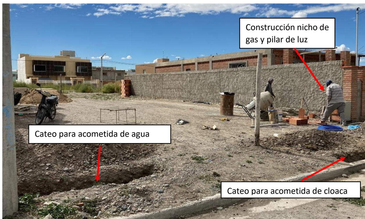
Figura 12: Cateos, nicho de gas y pilar de luz
