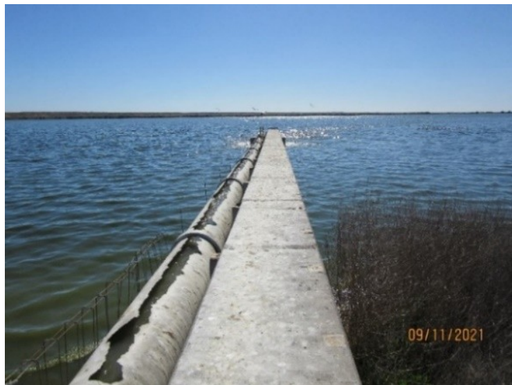
Fig.11: Entubamiento, descarga de líquidos cloacales en laguna del caño.
