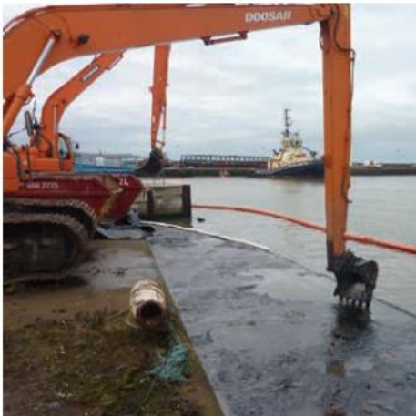
Imagen 14. Uso de maquinaria de ingeniería civil para retirar hidrocarburos de un área portuaria. En esta situación en particular, la temperatura del agua se encontraba por debajo del punto de fluidez de los hidrocarburos, por lo tanto, estos se encontraban en estado semisólido dificultando el uso de skimmers. (ITOPF-Promoting Effective Spill Response (i), 2022)
