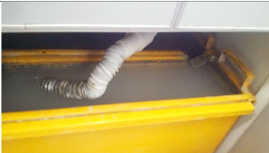
Decantador de gruesos, bajo pileta
