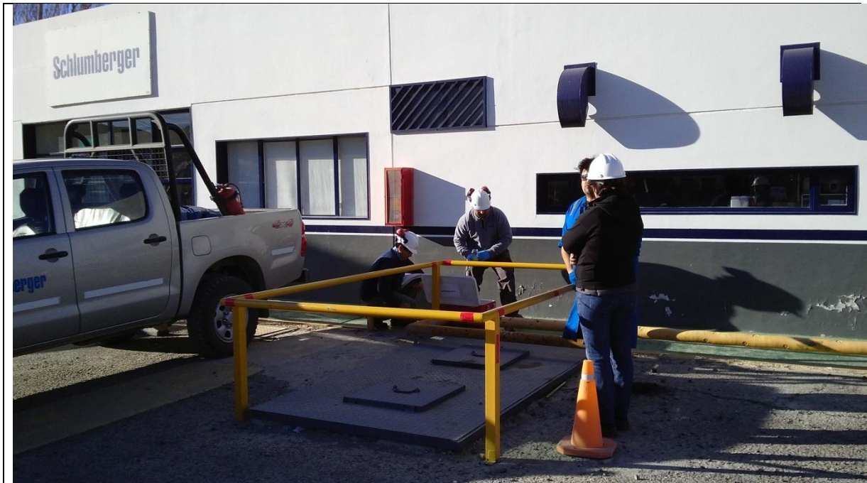
Sistema de tratamiento instalación exterior soterrada
