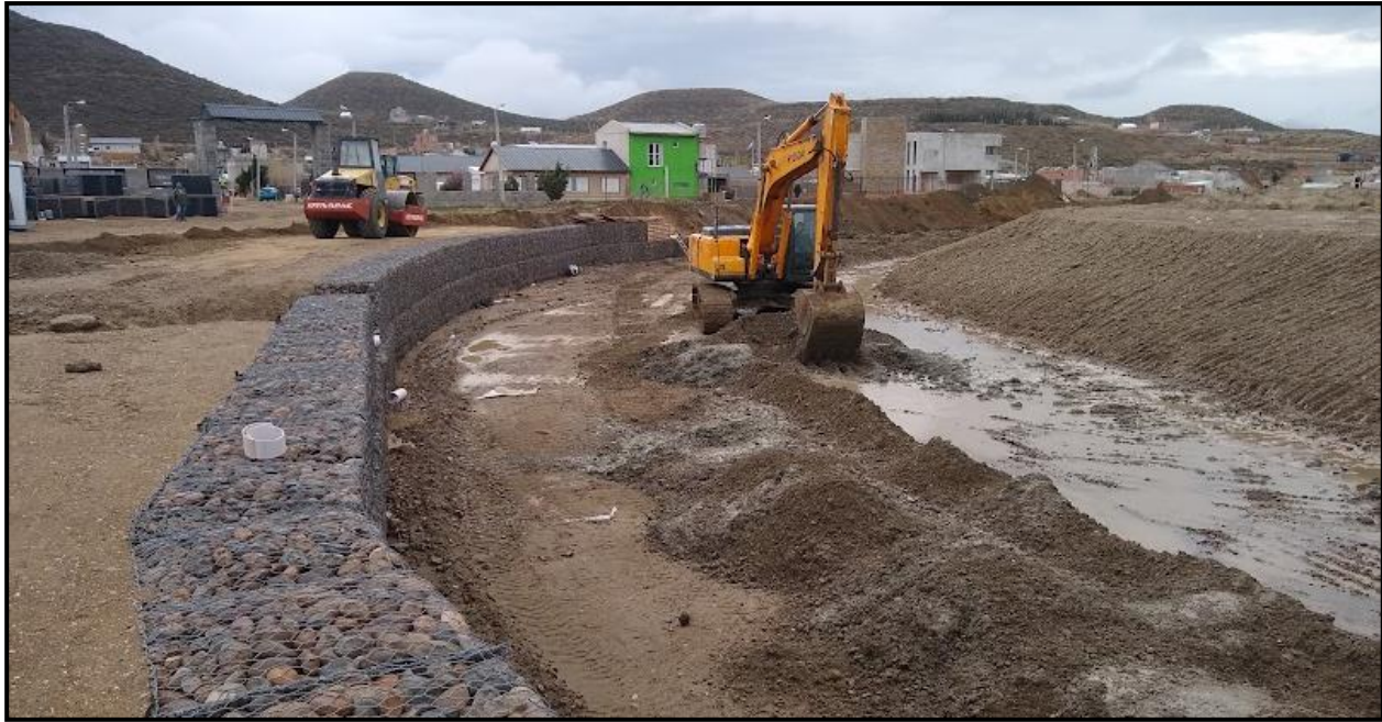
Imagen 84. Relleno en el trasdós del muro y nivelación en el cauce del arroyo. Puede verse la margen derecha perfilada adecuadamente luego de ser rellenada.
