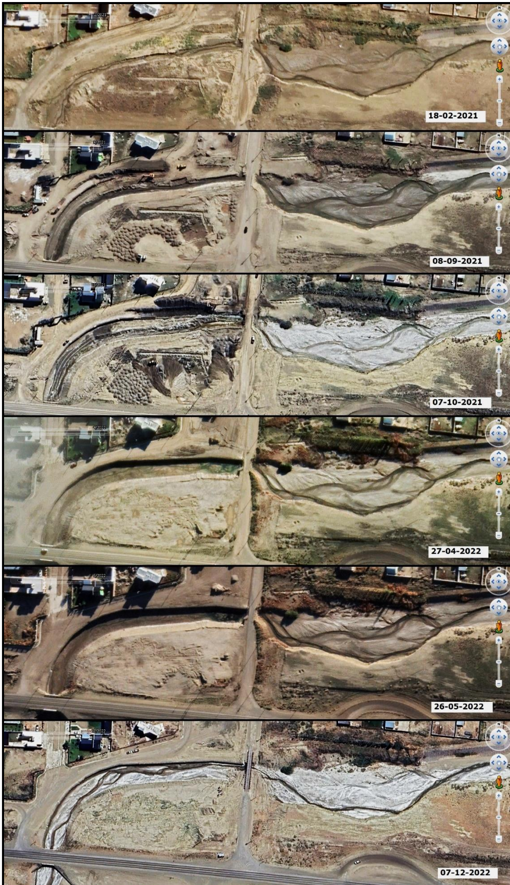
Imagen 79. Avance de la segunda etapa de la reparación de la margen izquierda, barrio Los Arenales.
