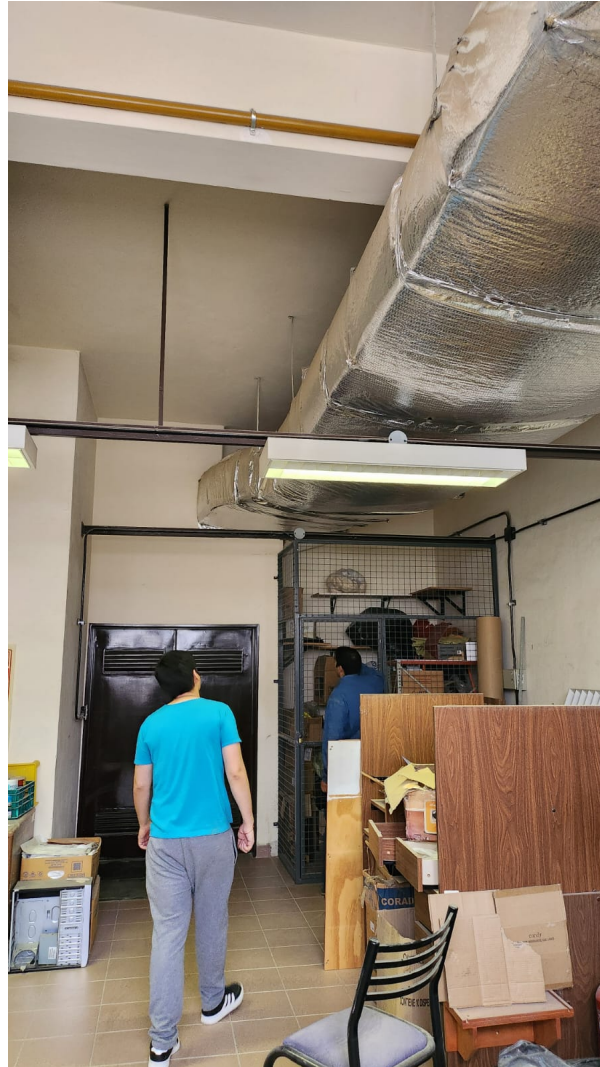
Figura 17: Conducto principal visto desde el interior de la sala de máquinas.
