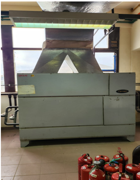
Figura 14: Fancoil de la Sala de Máquinas
