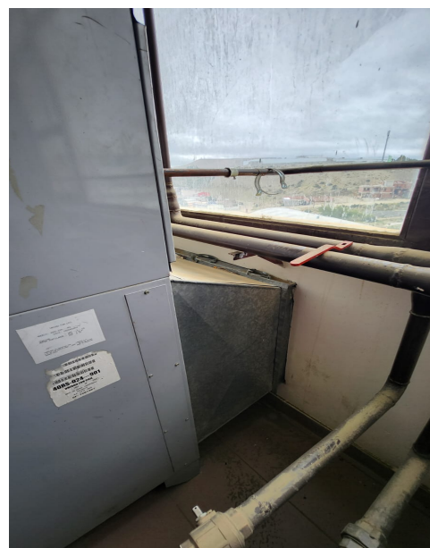
Figura 15: Entrada de aire al fancoil
