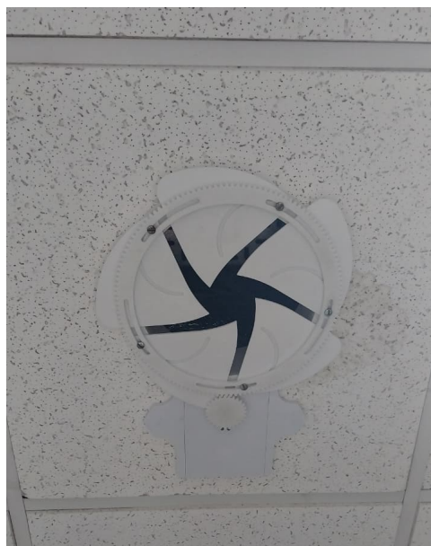
Figura 109: Difusor actuando por orden del control
