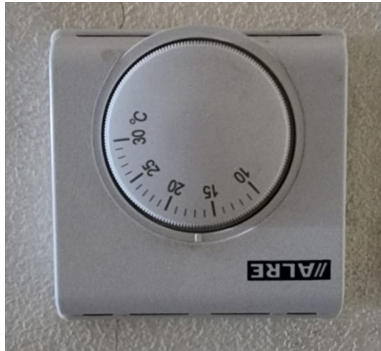
Figura 25: Termostato que controla el fancoil de la sala de máquinas.
