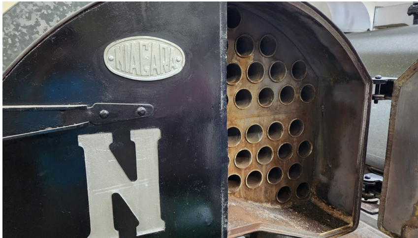
Figura 12: Interior de la caldera - Tubos de humo a la vista.
