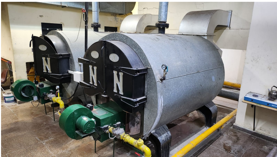
Figura 11: Calderas de 600 kcal/h ubicadas en el segundo subsuelo de la universidad.
