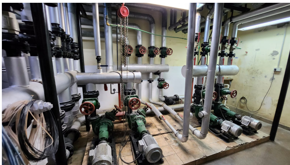
Figura 13: Sistema de bombeo
