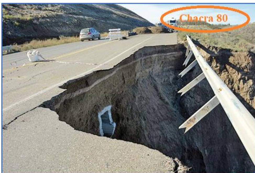
Ilustración 32. Corte de camino R. González tras temporal de 2017 (dos semanas interrumpido) en sentido Sur-Este. La coloración es propia. Fuente: propia, Junio 2017.
