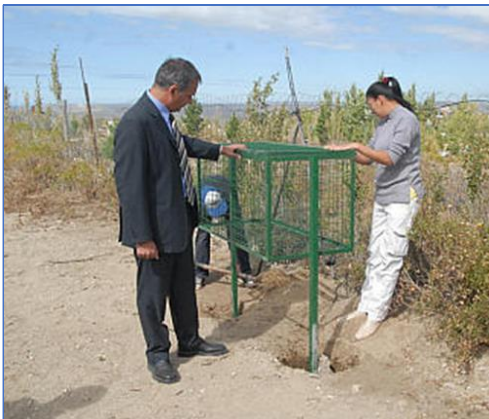
Ilustración 41. Instalación de uno de los veinte canastos comunitarios para residuos en el sector. PP 2010. Fuente Mar Australis , febrero de 2010 49 .
