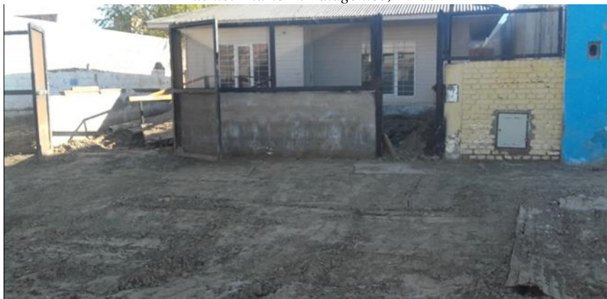
Imagen 29: Vivienda afectada por la catástrofe en B° Juan XXIII Fuente: elaboración propia, 2017.
