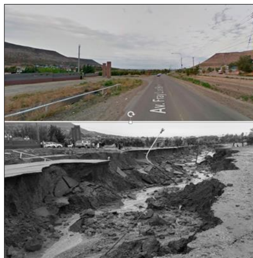
Imagen 22: Antes y después de la Av. Fray Luis Beltrán Fuente: elaboración propia, 2019.
