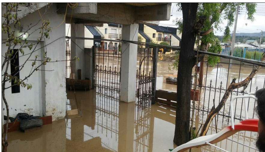
Imagen 31: Vivienda inundada en B° Juan XXIII Fuente: Diario El Patagónico, 2017.
