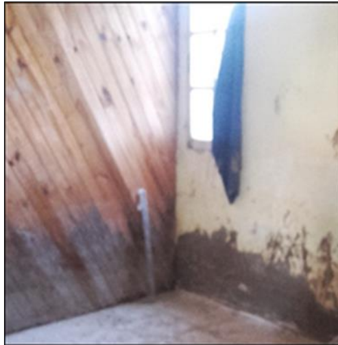
Imagen 9: Marca de barro y humedad Fuente: elaboración propia, 2017.
