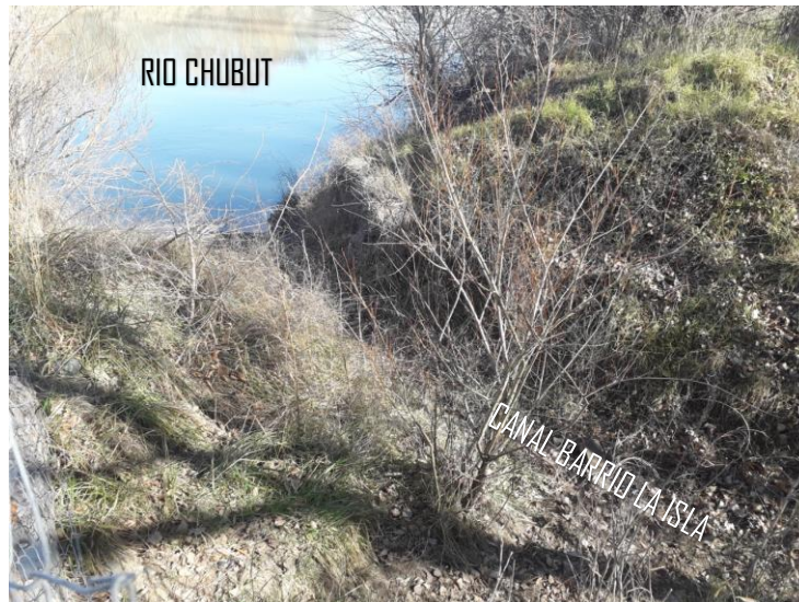
Imagen 2. Nacimiento del canal, donde se observa el agua no logra ingresar al mismo
