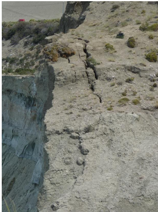
Fig.1.3- Bloques inestables consecuencia del avance progresivo en profundidad de grietas de tracción (talud costero Comodoro Rivadavia, coordenadas -45.850495,-67.474414,17).
