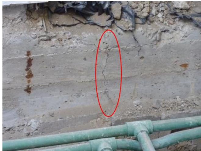
Fig.1.13- Viga portamuros afectada por el hinchamiento de un suelo (GAclay) de muy alto potencial de expansión (construcción unifamiliar de dos plantas fundada sobre pilotes cortos construida en 2010, -45.871889,-67.521590,19).
