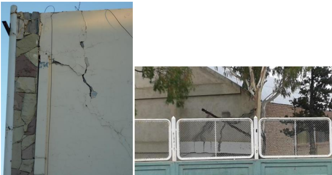
Fig.1.11- Patologías desarrolladas en Club Deportivo construido por etapas entre las décadas del '30 y '60, fundado sobre sistemas mixtos de cimentación (44°50'27" S/67°28'36" W).
