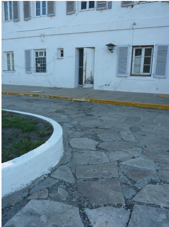
Fig.1.10- Edificio declarado Monumento Histórico Nacional construido en el año 1919 fundado sobre suelos expansivos empleando un sistema de cimentación superficial de época constituido por muros ensanchados de mampostería (45°50'56" S/67°28'28" W ).
