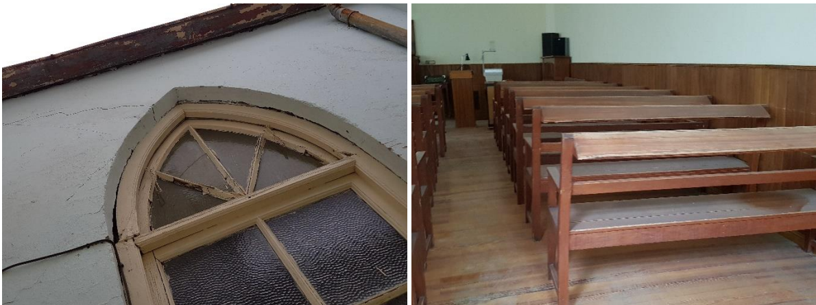
Fig.1.9- Patologías presentadas en una Iglesia Evangélica construida en 1932 fundada sobre suelos expansivos empleando un sistema de cimentación superficial de época constituido por muros de mampostería ensanchados (45°44'44.5" S/67°29'06" W).
