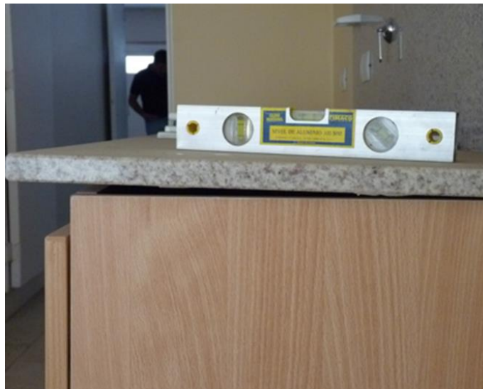
Fig.2.14- Deformaciones diferenciales producidas en zona de suelos expansivos (GAclay)
