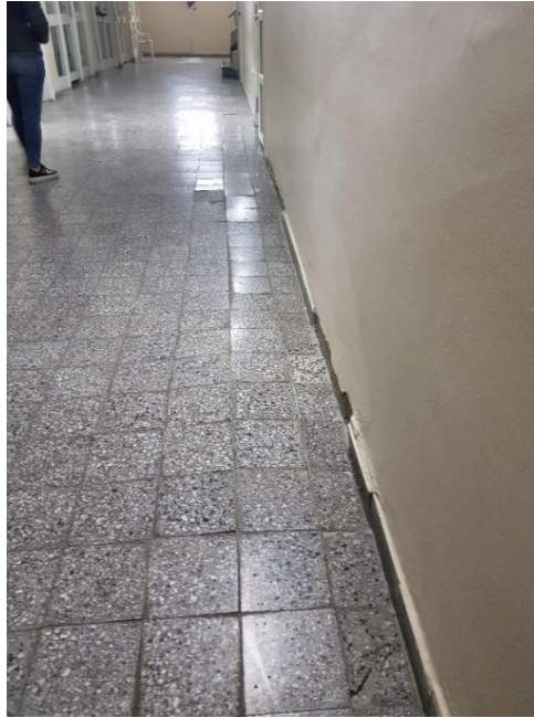
Fig.1.12- Deformaciones diferenciales en subsuelo de Club Deportivo construido entre la década del '30 y el '60, coordenadas -45.841034,-67.476938,19) con contrapisos apoyados directamente sobre un suelo con potencial de expansión muy alto (FRclay) y sistema de cimentación sobre pilotes.
