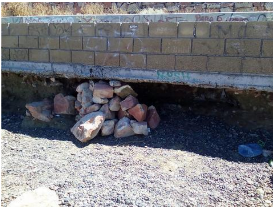
Figura 33: Solución provisoria de vecinos. Fuente propia. Fecha: 20 enero 2021
