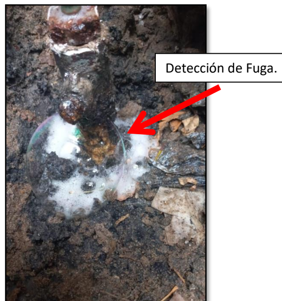
Imagen N°5: Fuga en servicio de acero, aguas arriba de válvula de corte.
