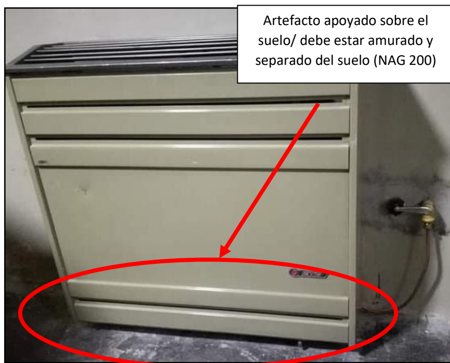
Imagen N°15: Instalación artefacto Calefactor deficiente.
