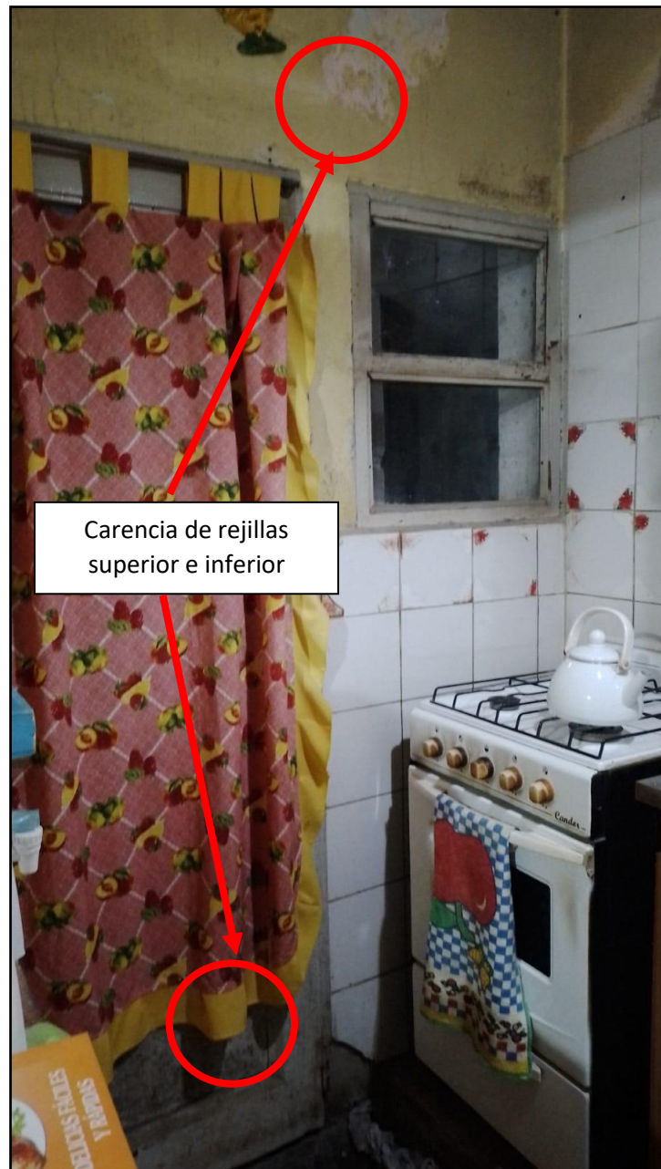
Imagen N°27: Anomalías en ambiente cocina.
