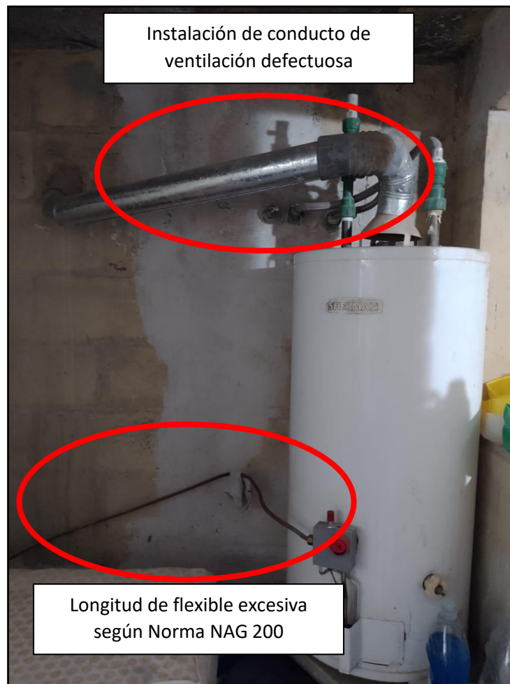
Imagen N°28: Anomalías en instalación artefacto Termotanque.
