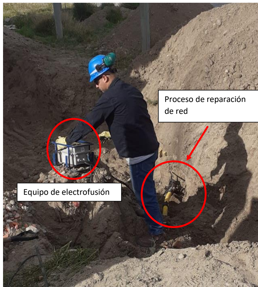
Imagen N°16: Rotura y Reparación en Red de polietileno \varnothing 90 mm que distribuye a Barrio Rodaj Park (Rawson).
