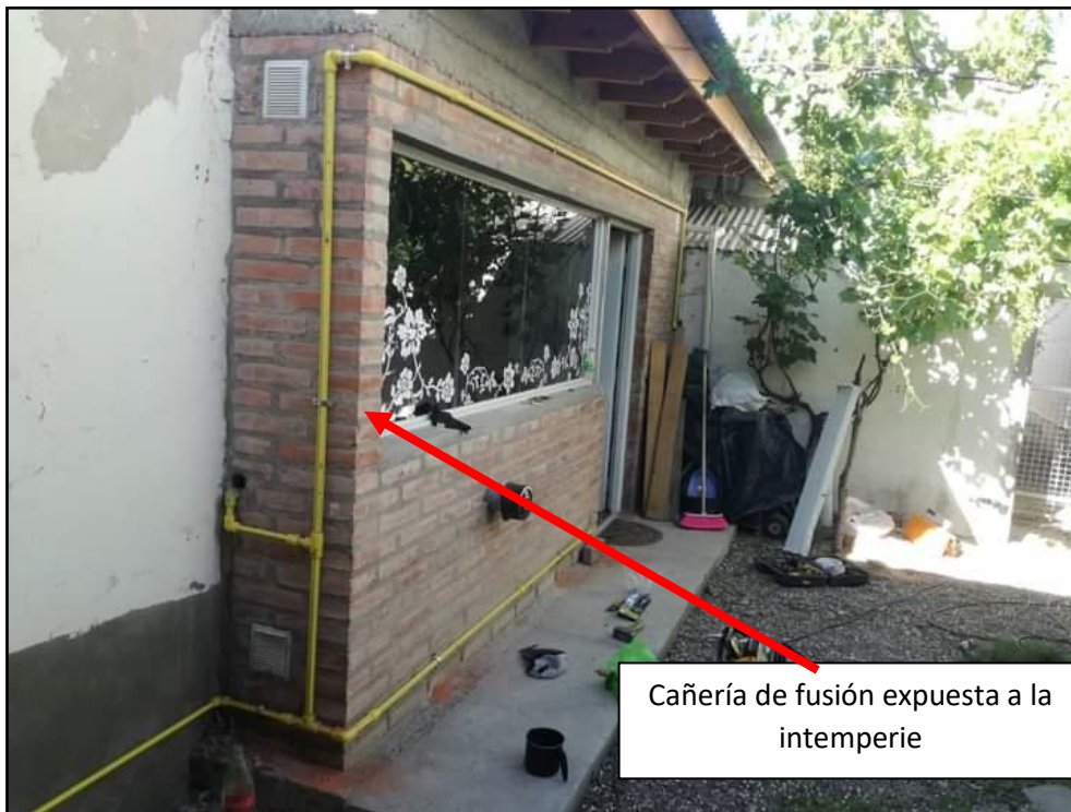
Imagen N°14: Cañería mal instalada.
