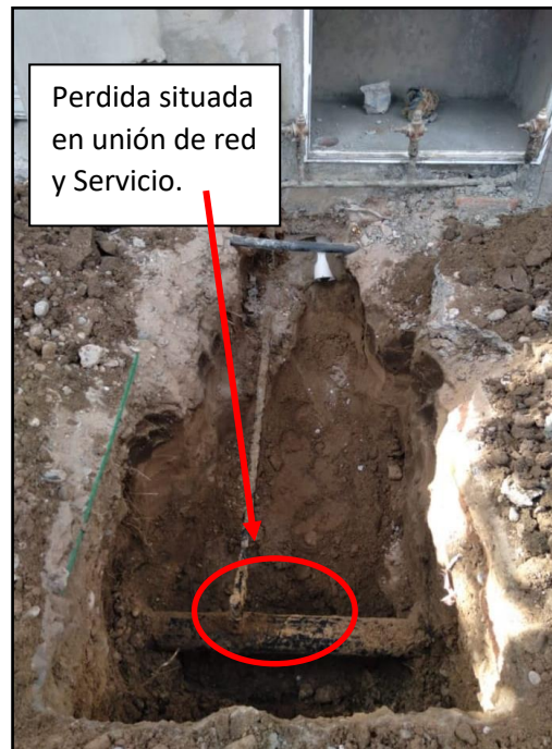
Imagen N°6: Fuga en Red de acero.
