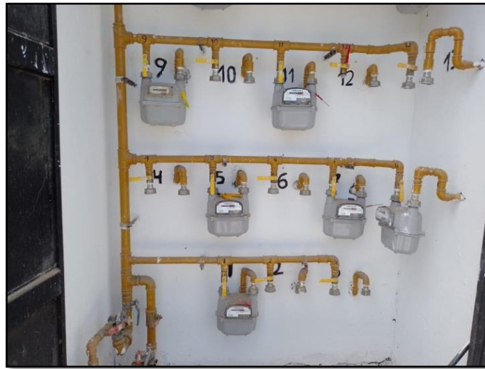
Imagen N°4: Barral de medidores en Edificios.
