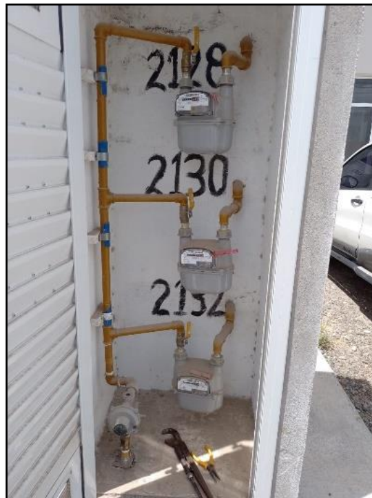
Imagen N°3: Baterías de Medidores.
