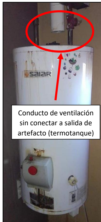
Imagen N°13: Deficiente Instalación de conducto de ventilación.
