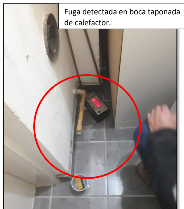
Imagen N°10: Detección de Perdida en instalaciones internas con equipo Explosímetro.
