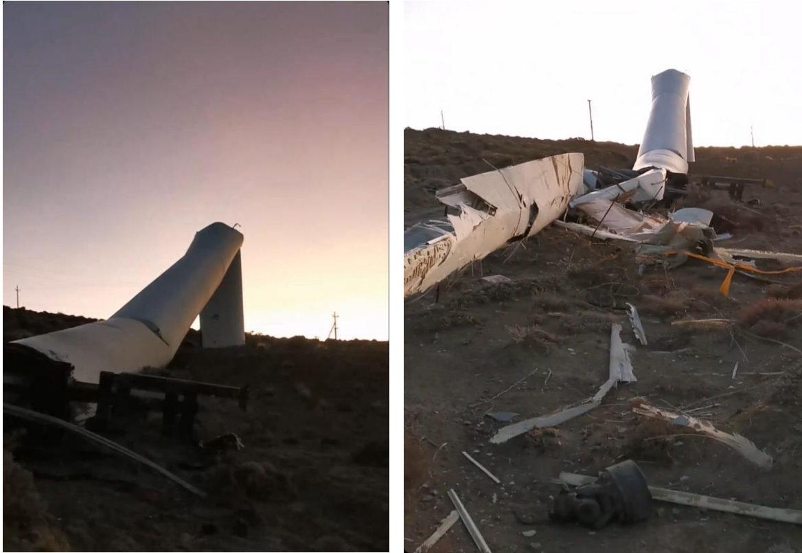
Figura 13. AEROGENERADOR DEL ANTIGUO PARQUE ANTONIO MORAN. FUENTE: ELABORACIÓN PROPIA. AGOSTO 2023
