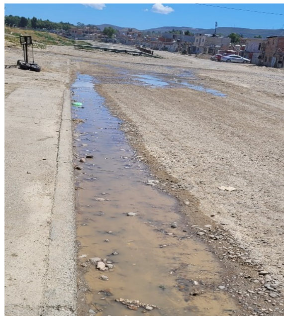
Figura 13. Filtraciones de aguas residuales en calles
