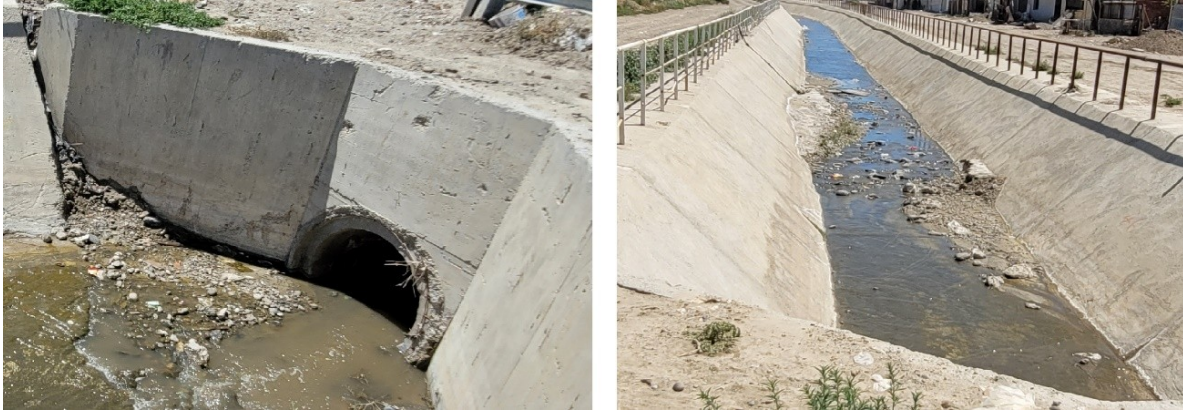
Figura 12. Escurrimiento de aguas cloacales
