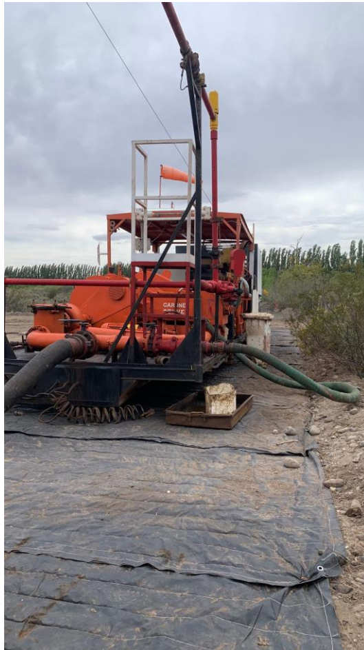
Figura N° 31. Equipo de Pulling. Circulación de fluidos
