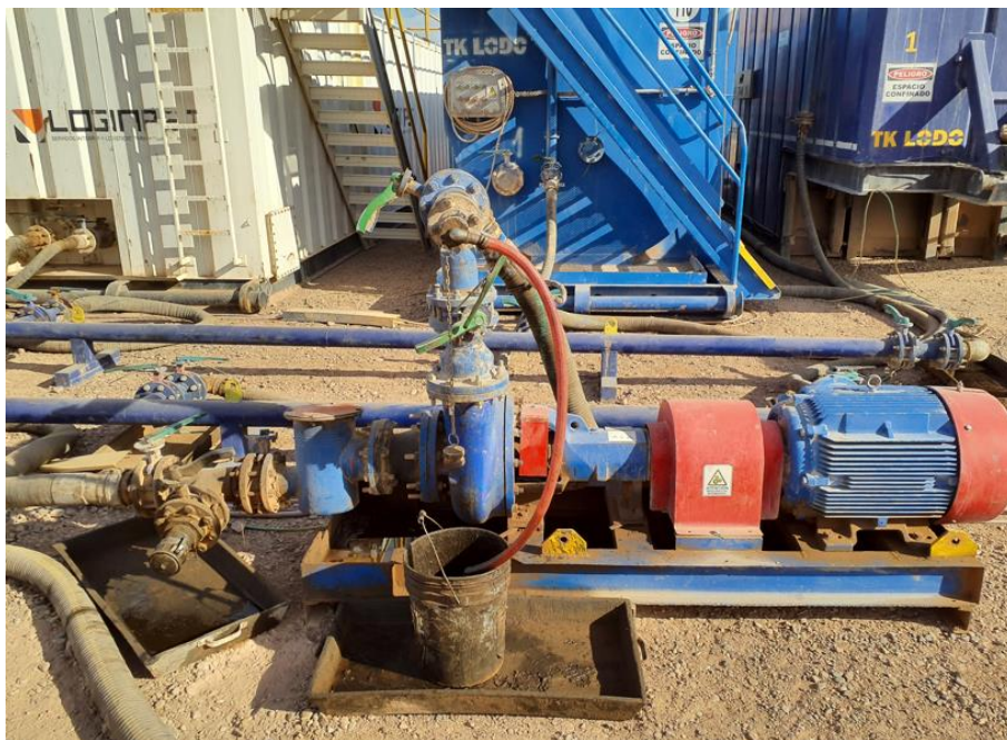
Figura N° 41. Equipo de Perforación. Bandejas debajo bomba impulsora
