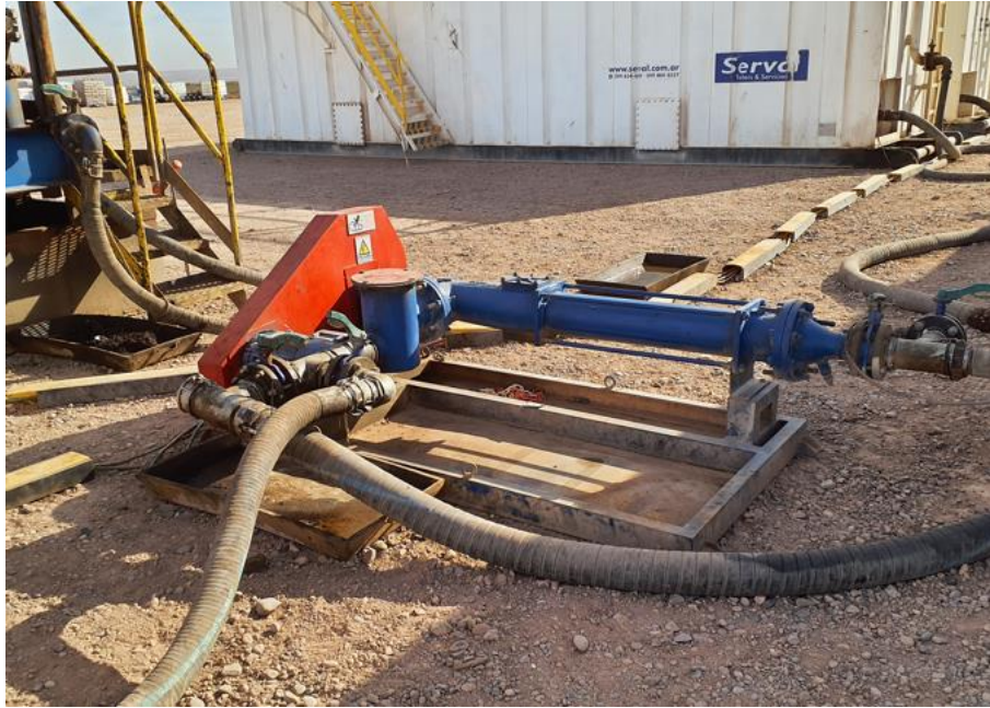
Figura N° 44. Equipo de Work Over. Bandejas debajo de conexiones de líneas
