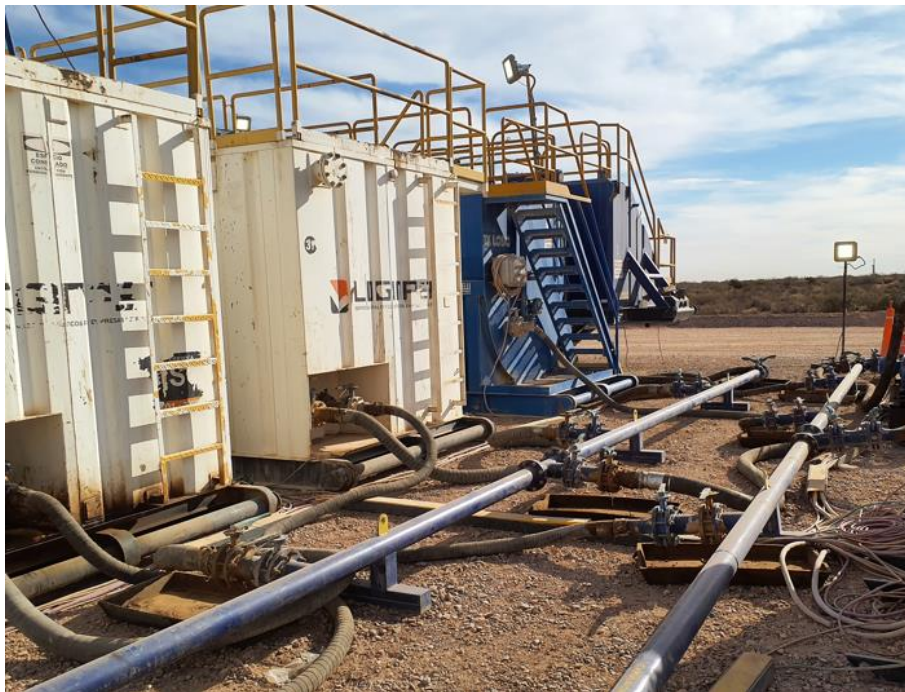
Figura N° 43. Equipo de Perforación. Bandejas debajo de conexiones de líneas
