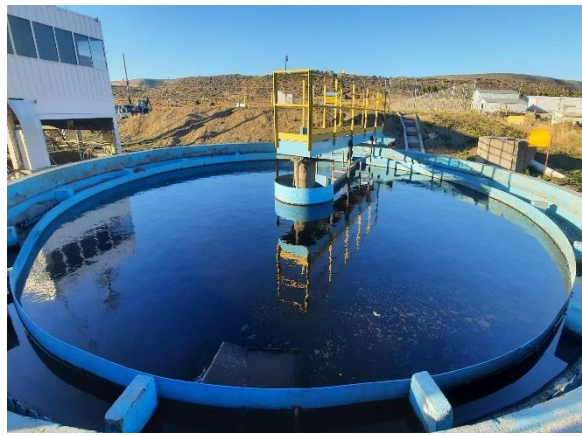
Fig A2: Sedimentador funcionando de forma óptima. Fecha: 04/04/2025.
