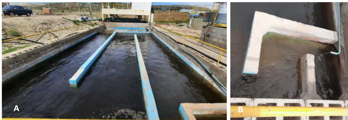
Fig 8: Cámara de cloración. (A) Vista de las paredes internas que delimitan el recorrido del agua. (B): Tubería dosificadora de cloro al ingreso de la cámara. Fuente: Elaboración propia.
