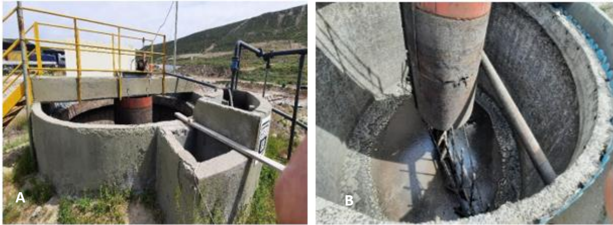
Fig 7: Concentrador de lodos. (A): Vista externa del concentrador. (B). Vista interna del concentrador con barredor de fondo. Fuente: Elaboración propia.
