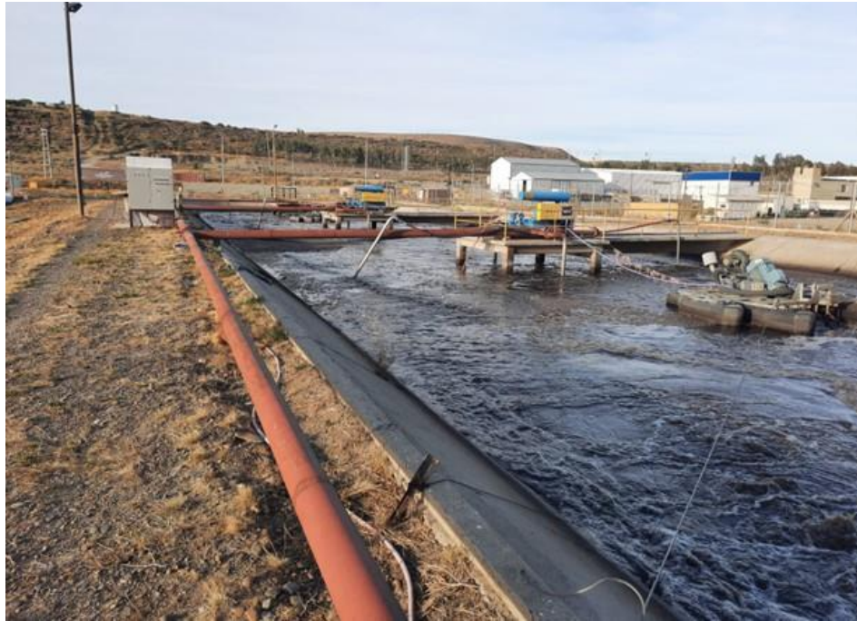
Fig 5: Reactor aeróbico de la PTEC. Se observan los equipos aireadores ubicados sobre pasarelas de hormigón y los agitadores de superficie. Fuente: Elaboración propia.
