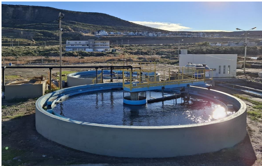
Fig 6: Sedimentadores secundarios de la PTEC. Fuente: Elaboración propia.
