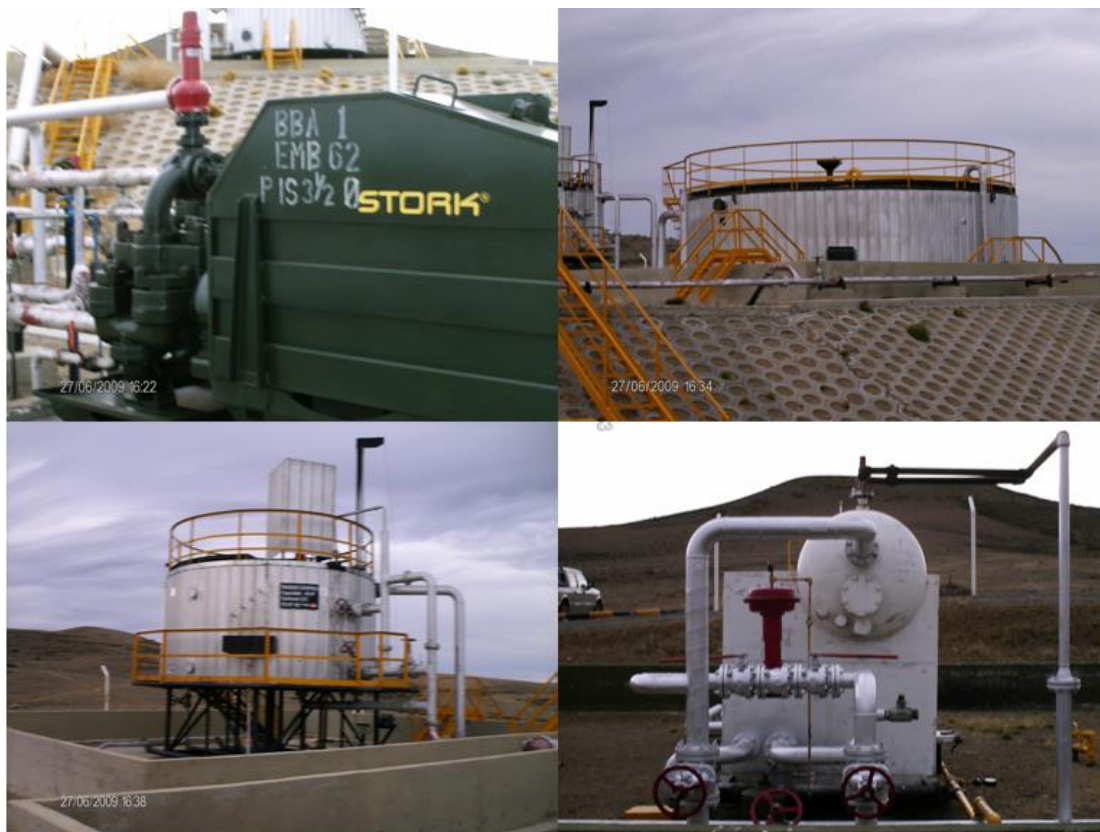
Figura 4.9.1.2 – Parque de bombas, tanques de almacenamiento y control y separadores
