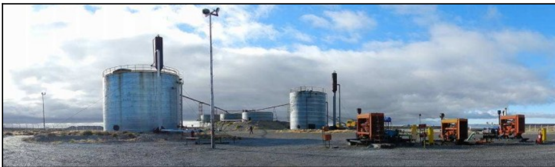
Figura 23: Vista de la Planta de tratamiento.
