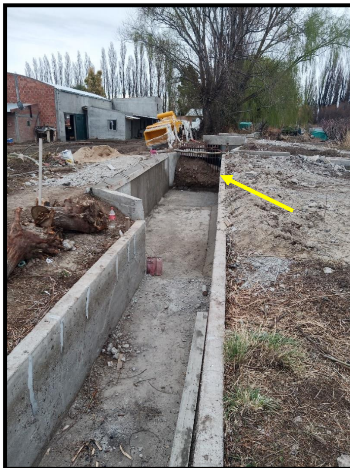
Figura.8: Sección de cabecera del tramo del canal Thomas analizado. Con la flecha se señala donde se colocó la compuerta automática de nivel constante aguas abajo.
