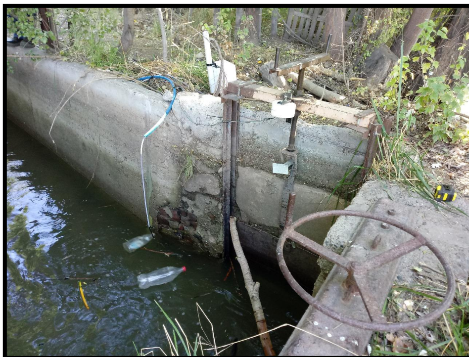
Figura.6: Sensor de medición y compuertas planas en compartó existente.
