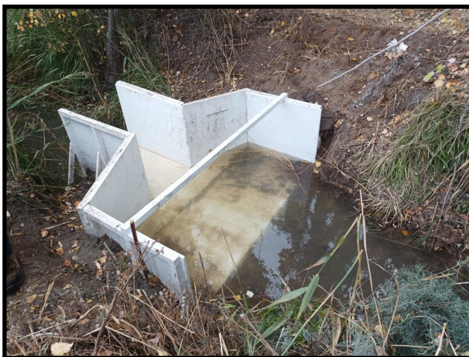
Figura 13: Aforador N°1 de garganta ancha, ubicado en zona intermedia.
