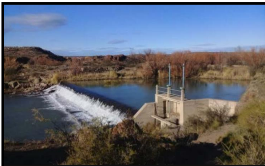
Figura 2: azud nivelador sobre el Río Chubut, desde donde se originan los canales principales del sistema de riego.
