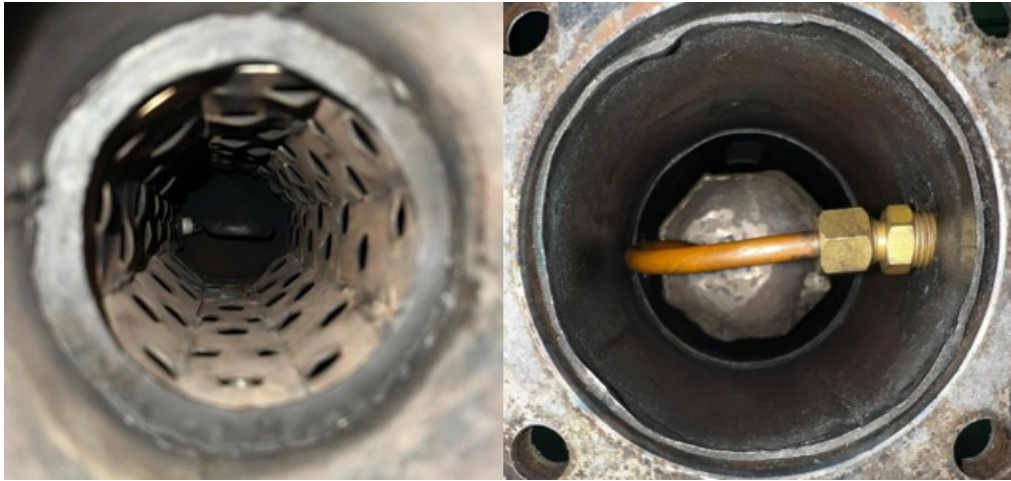
Imagen 5: Interior de la cámara de combustión
