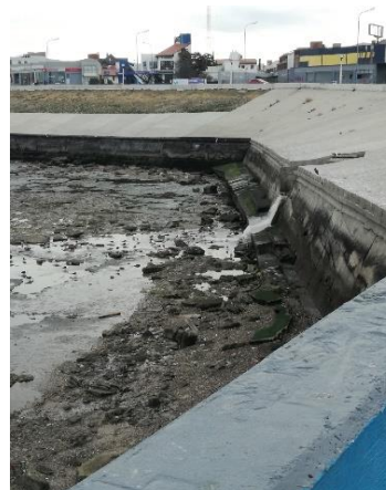
Ilustración 36 Desagüe de cloaca y pluvial. Fuente: Propia. 14/08/2021
