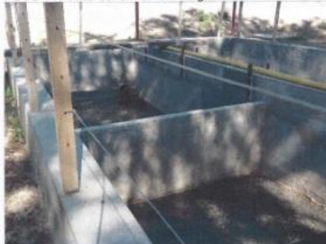
FOTO 11. Vista del efluente de ingreso al sedimentador.
