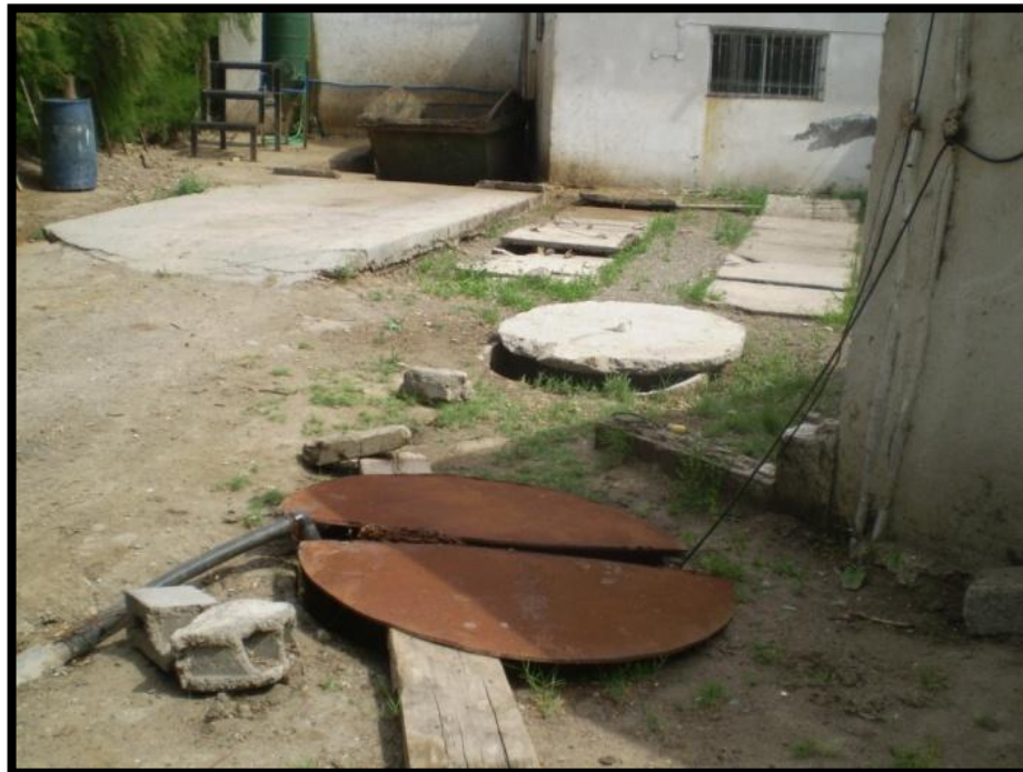
Imagen 23: Vista general del sistema de tratamiento primario.
