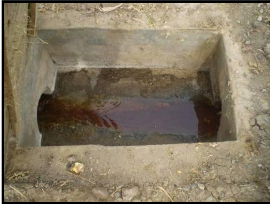
Imagen 4: Cámara de inspección previa al sistema de de desbaste.
