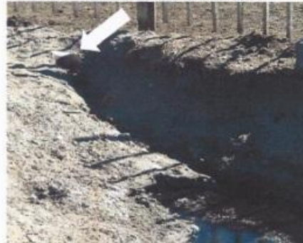
Foto 18. Salida del efluente a la excavación.
