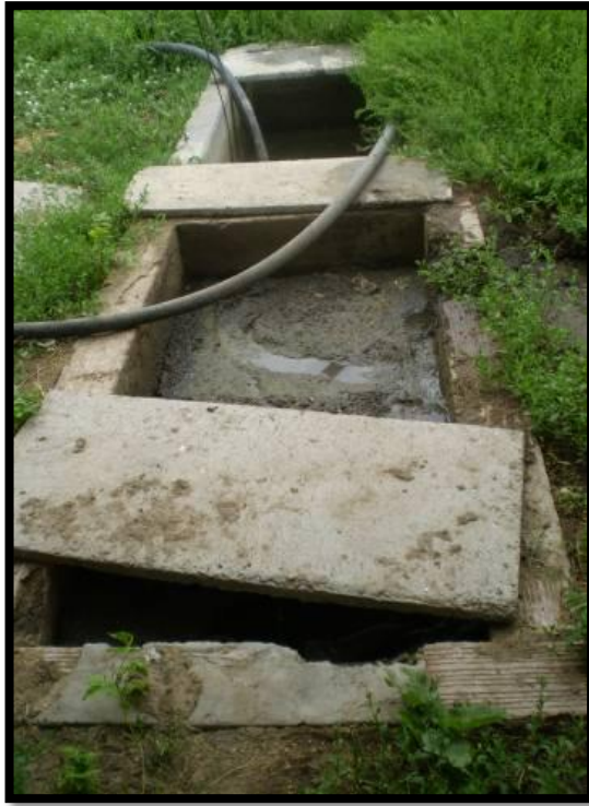
Imagen 16: Sedimentador del lavadero de camiones.
