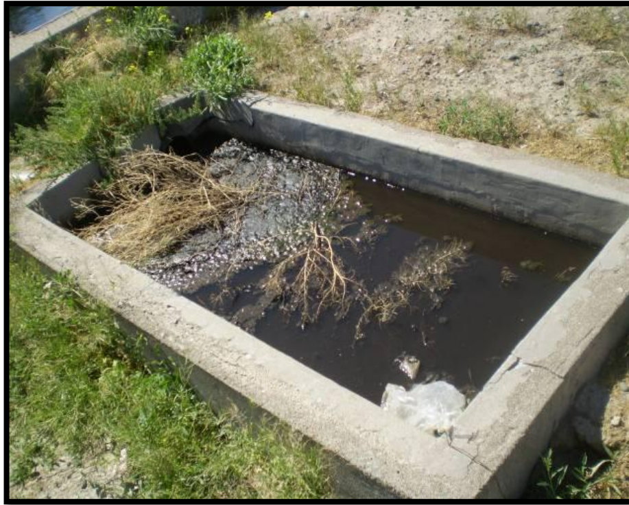
Imagen 47: Cámara de inspección, previa a las lagunas.
