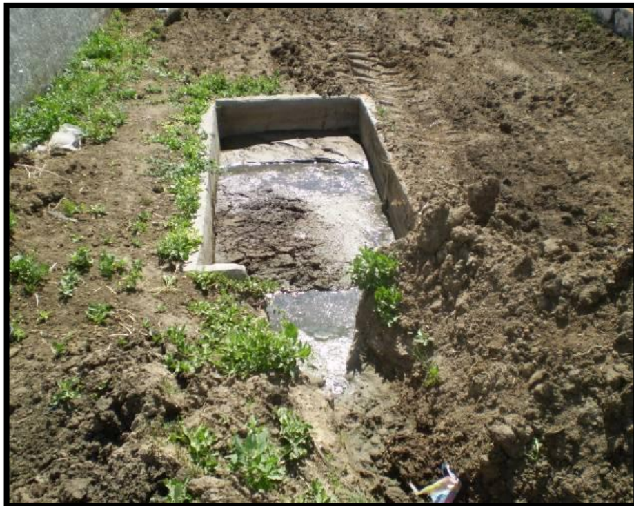
Imagen 52: Cámara del lavadero de camiones.
