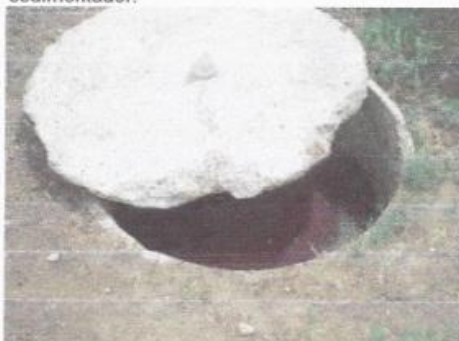
4. Detalle de efluente en cámara posterior al sedimentador.
