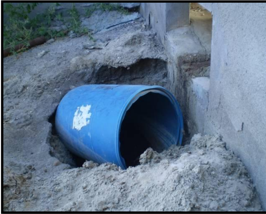
Imagen 55: Tambores para contención del efluente del salado de cueros mal colocado.
