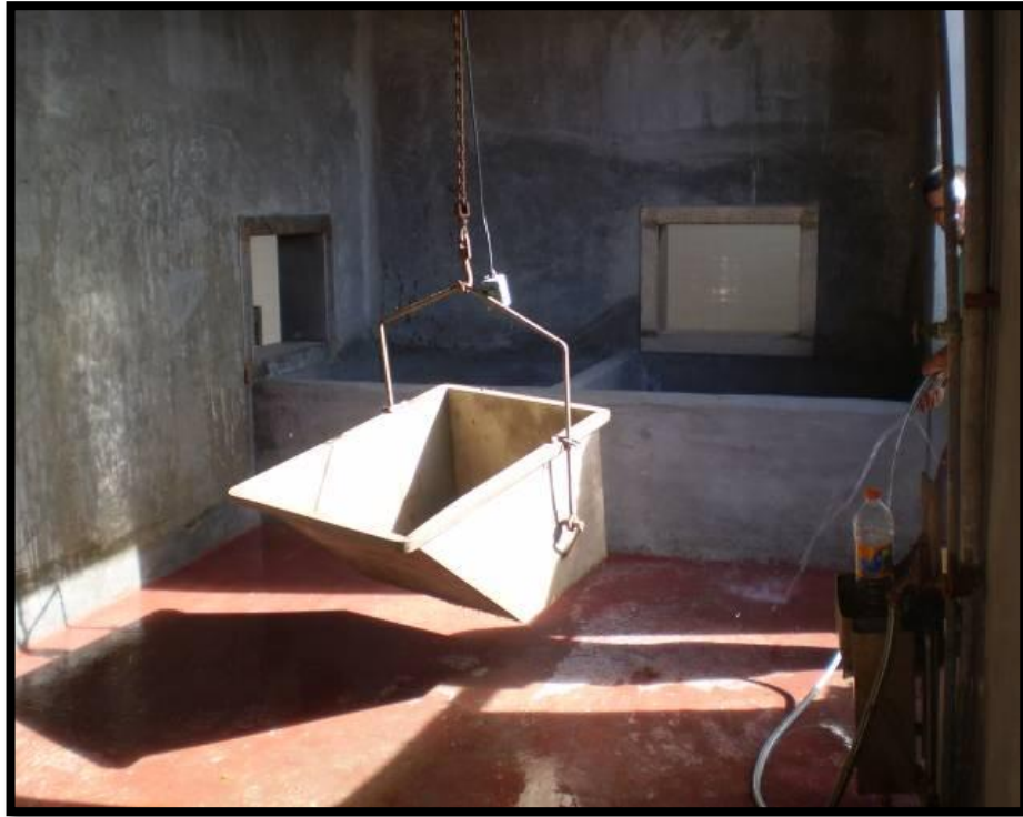
Imagen 59: Dispositivo de carga del digestor.
