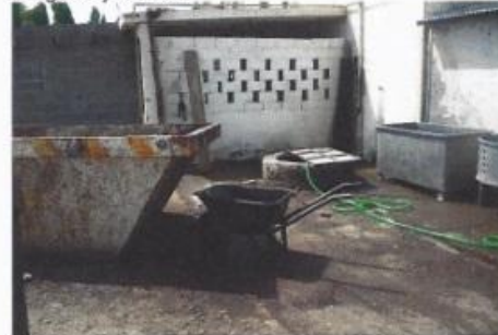
FOTO 11. Contenedor de patas y cabezas, cámara con manguera y bomba.
