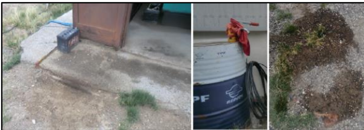
Figura 18: algunos de los residuos y pasivos ambientales de la central diésel. Fuente: elaboración propia.
