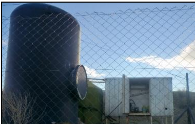
Figura 5: estación cloradora de Sepaucal. Fuente: propia.
