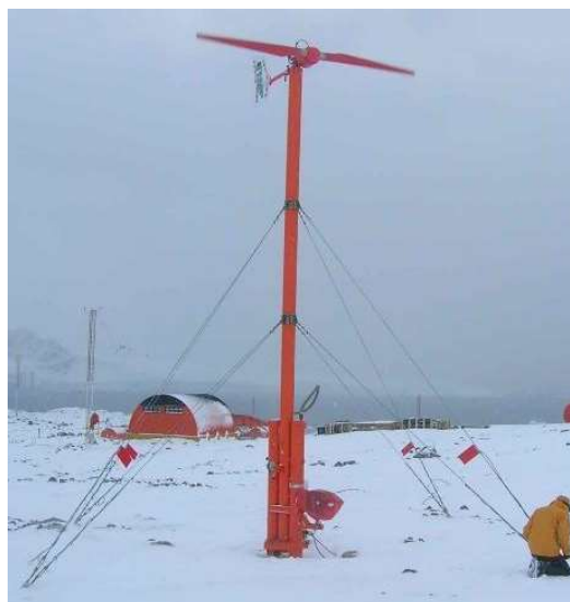
Figura 5.19: aerogenerador IVS 4500 instalado en la Antártida Argentina.
