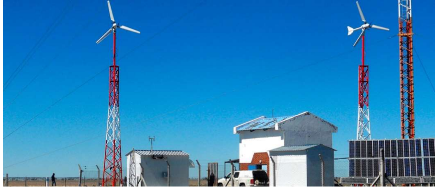
Figura 5.21: aerogeneradores E70 instalados en La Gauchita, Chubut.
