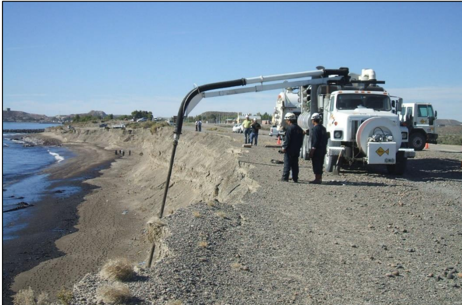
Foto 9: Camión de alto vacío (camión “chupa”) de empresa contratista, realizando tareas de recuperación del derrame desde cabecera del acantilado activo. Fuente: Archivo personal
